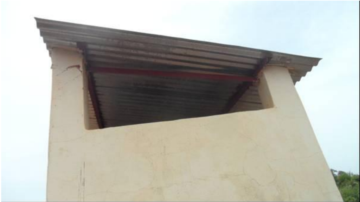
Toiture en matériaux autres que ceux du devis (pas de tôle bac, pas de IPN)
