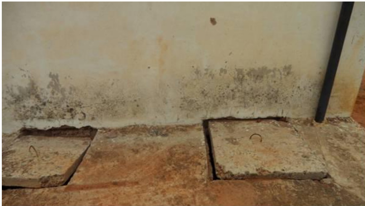
Risque d'insalubrité avec dalle fosse latrine mal fermée à Zingasso
