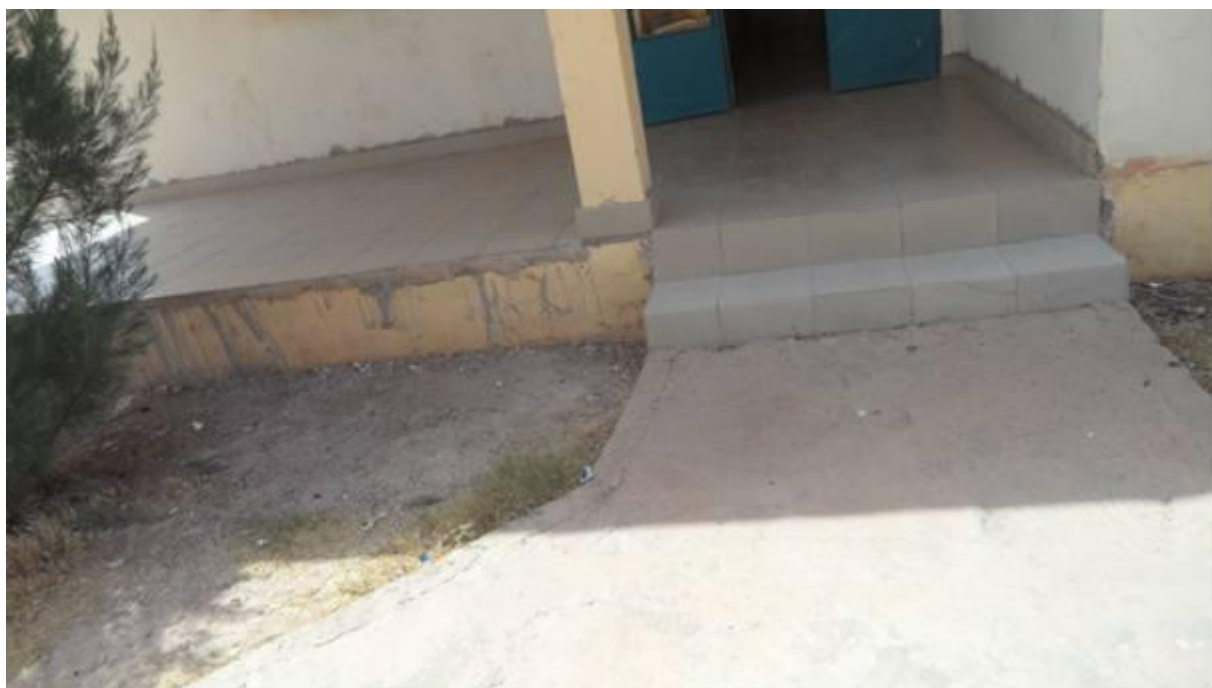
Finition approximative sur le bord de la terrasse qui méritait d'être carrelé
