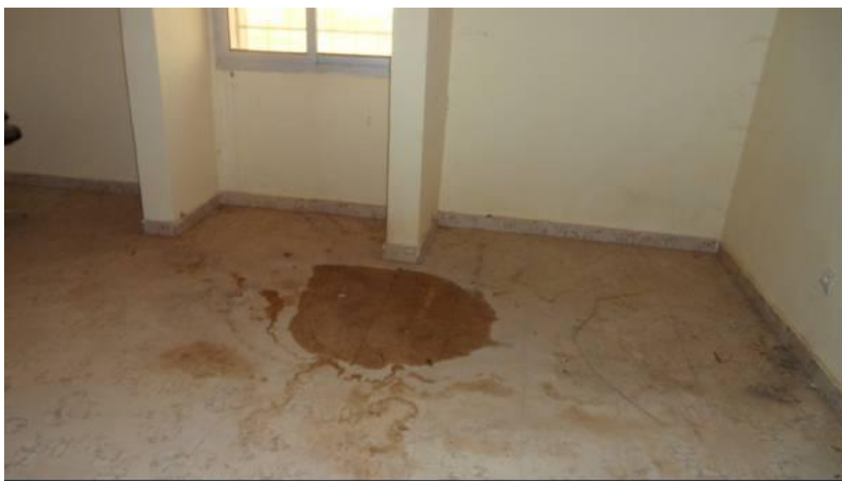
Bureaux mouillés par l'eau infiltration par plafond
