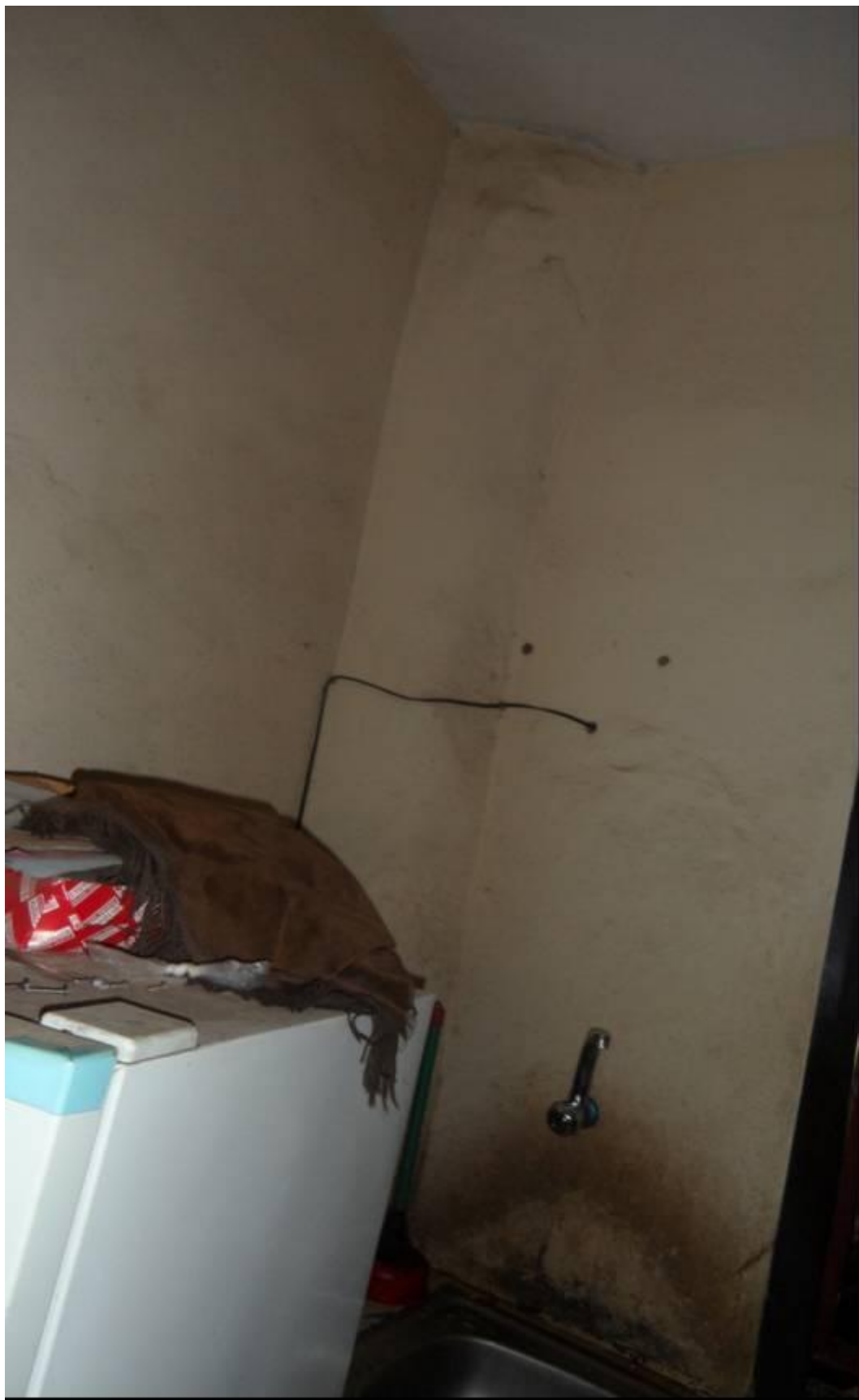
Noter la mauvaise finition d'une évacuation d'eau pluviale (l'inconfort au bureau d'un arrondi)
