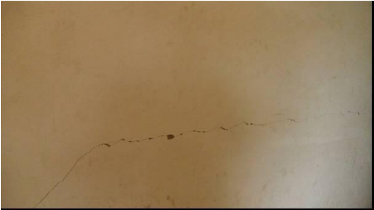
Fissure prononcée au mur
