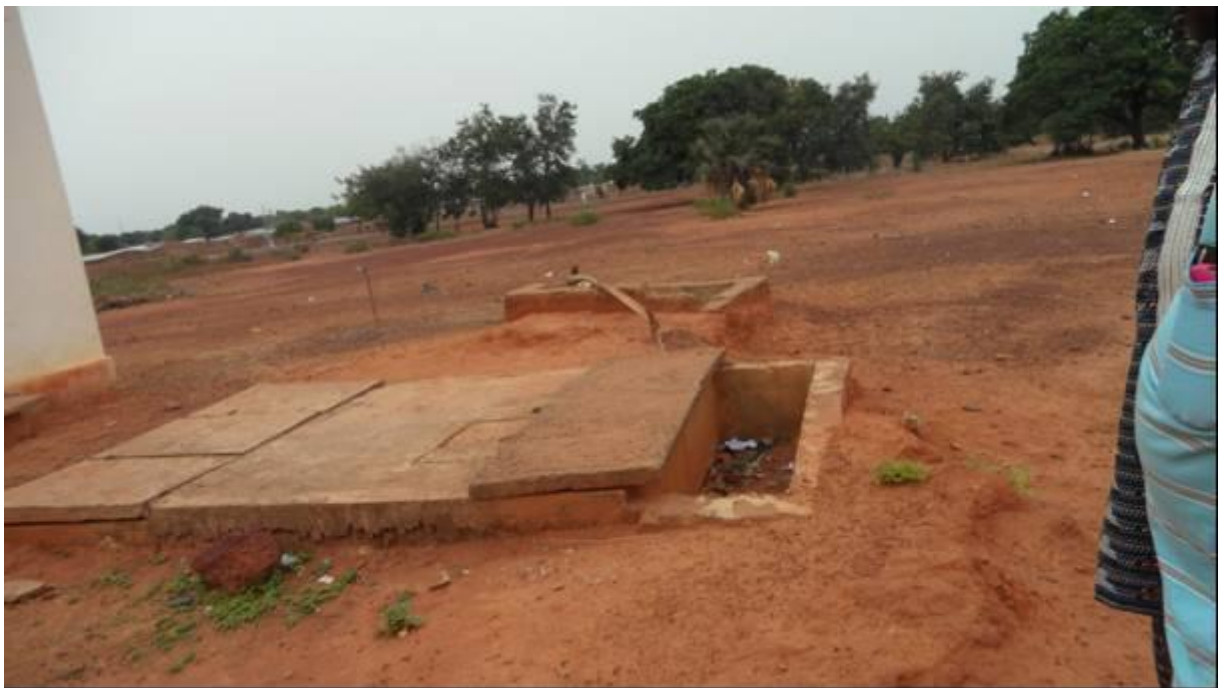
Faible épaisseur dalle-suppression filtre de la fosse septique à Zingasso
