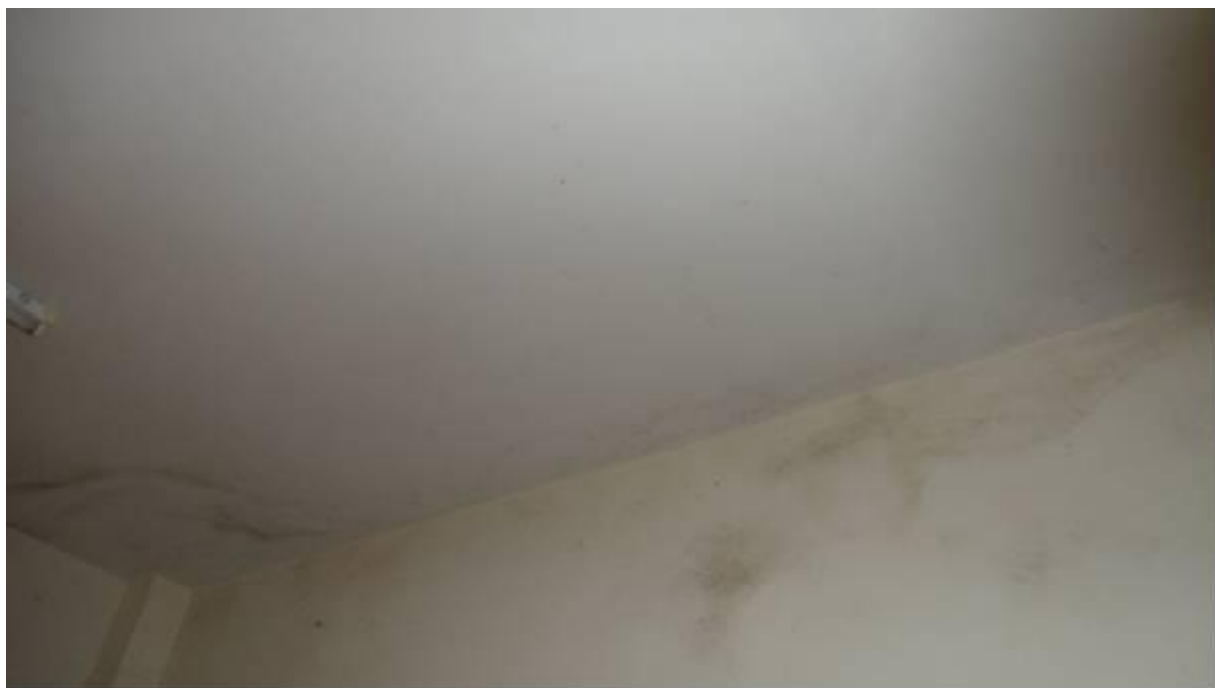
Plafond mouillé du fait de l'infiltration d'eau
