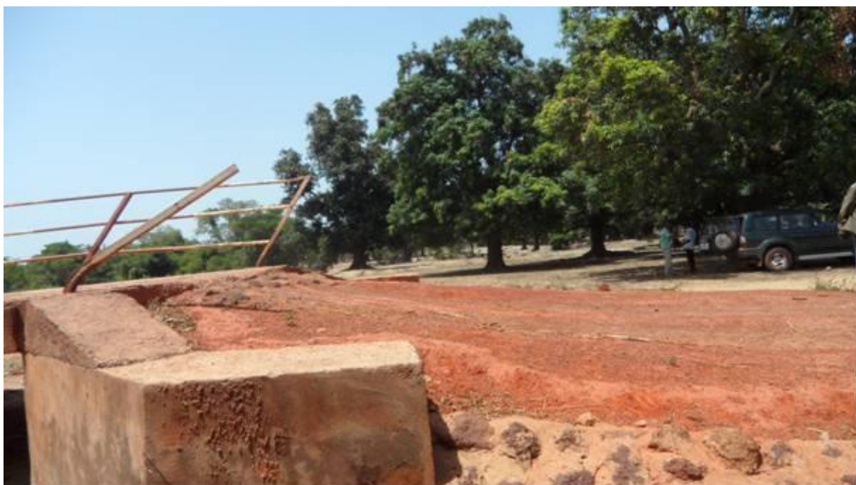
Etat de remblai mal compacté
