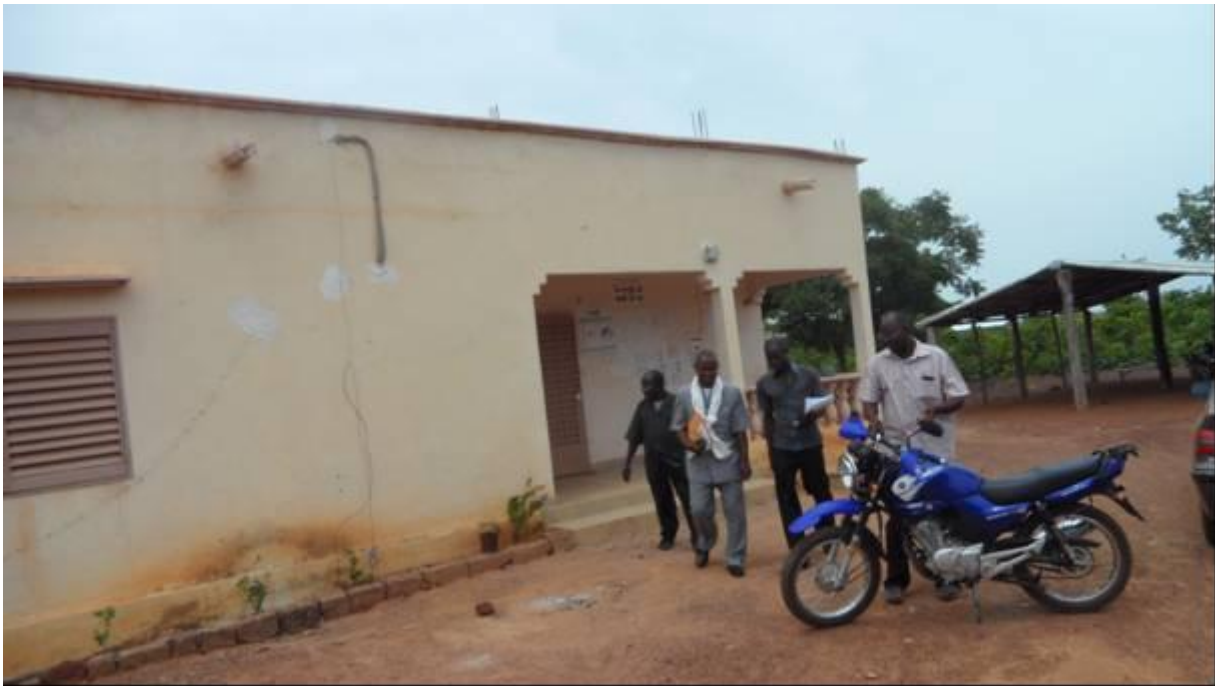
Présence humidité au mur sur une façade CAP de Garalo
