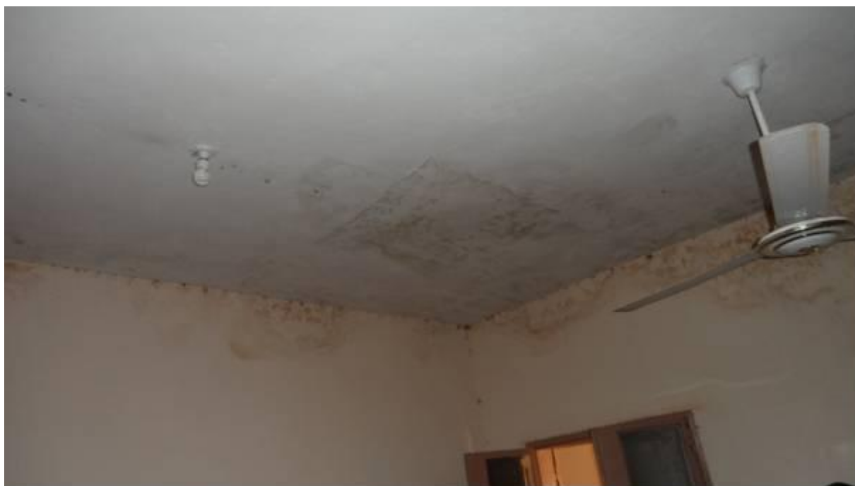
Humidité inconmodante au plafond et au mur
