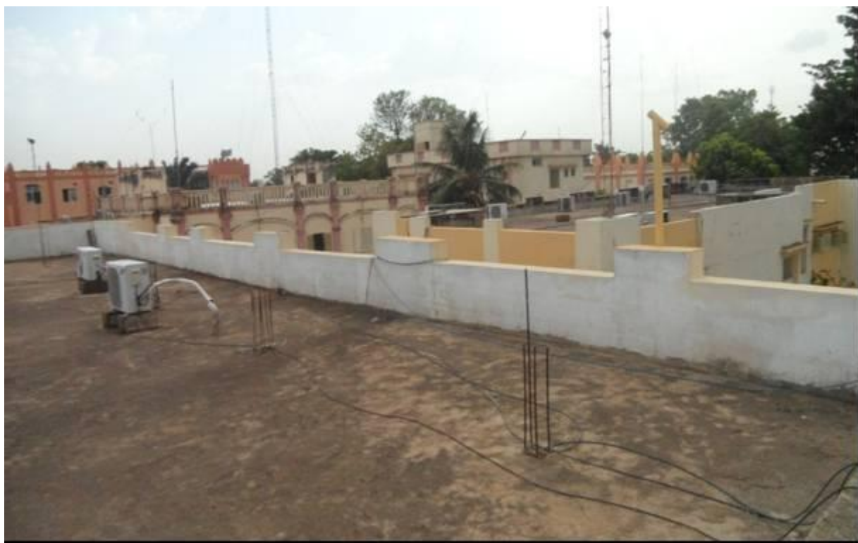
Vue de la dalle-aucun signe d'étanchéité ni de relevé d'étanchéité
