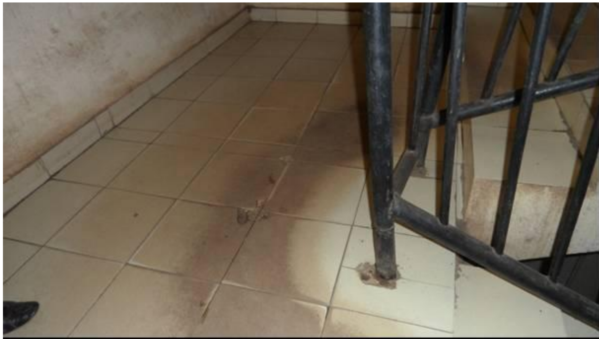
Trace de déteinte de carreau
