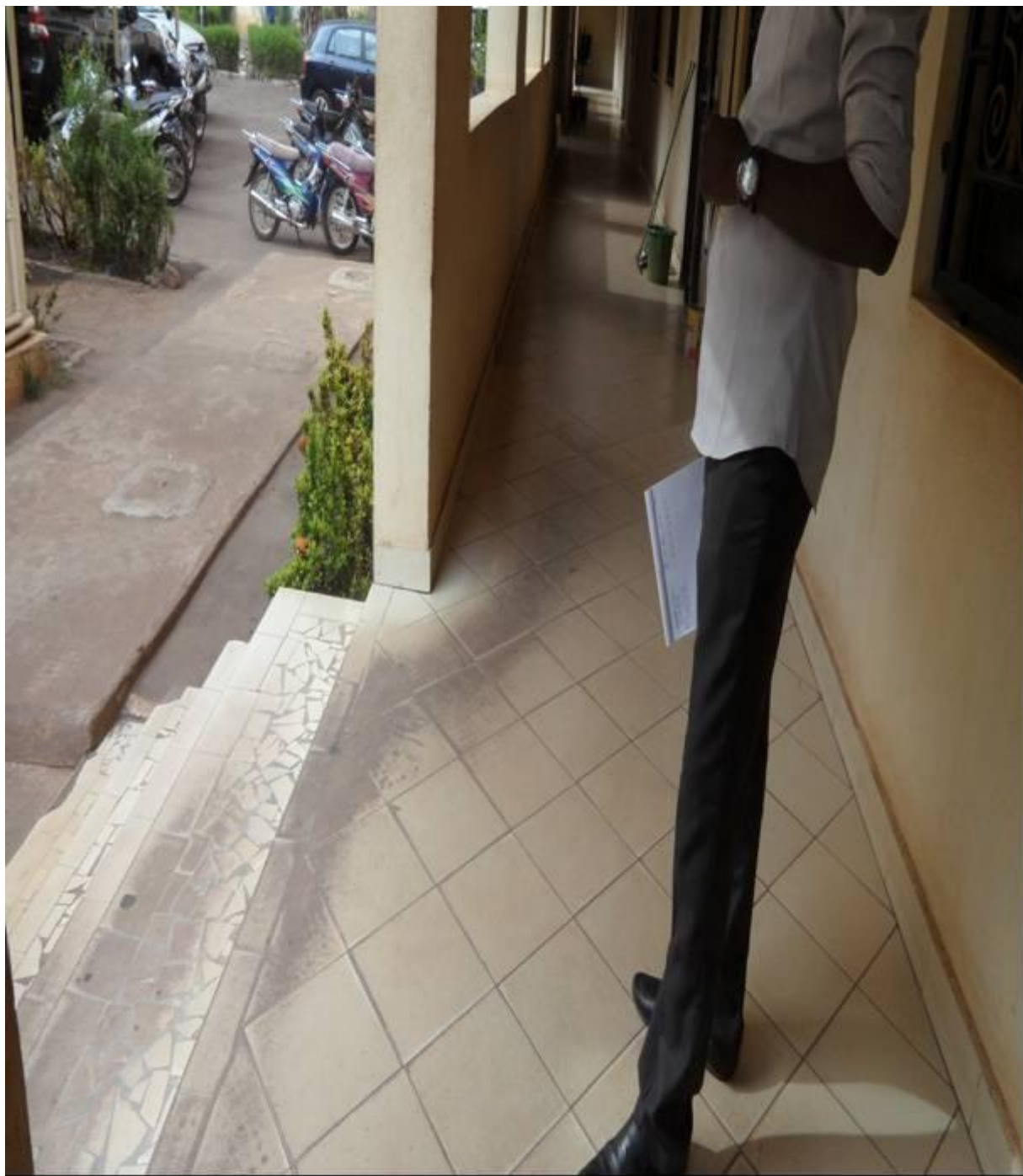
Déteinte du carreau sous passages à l'entrée
