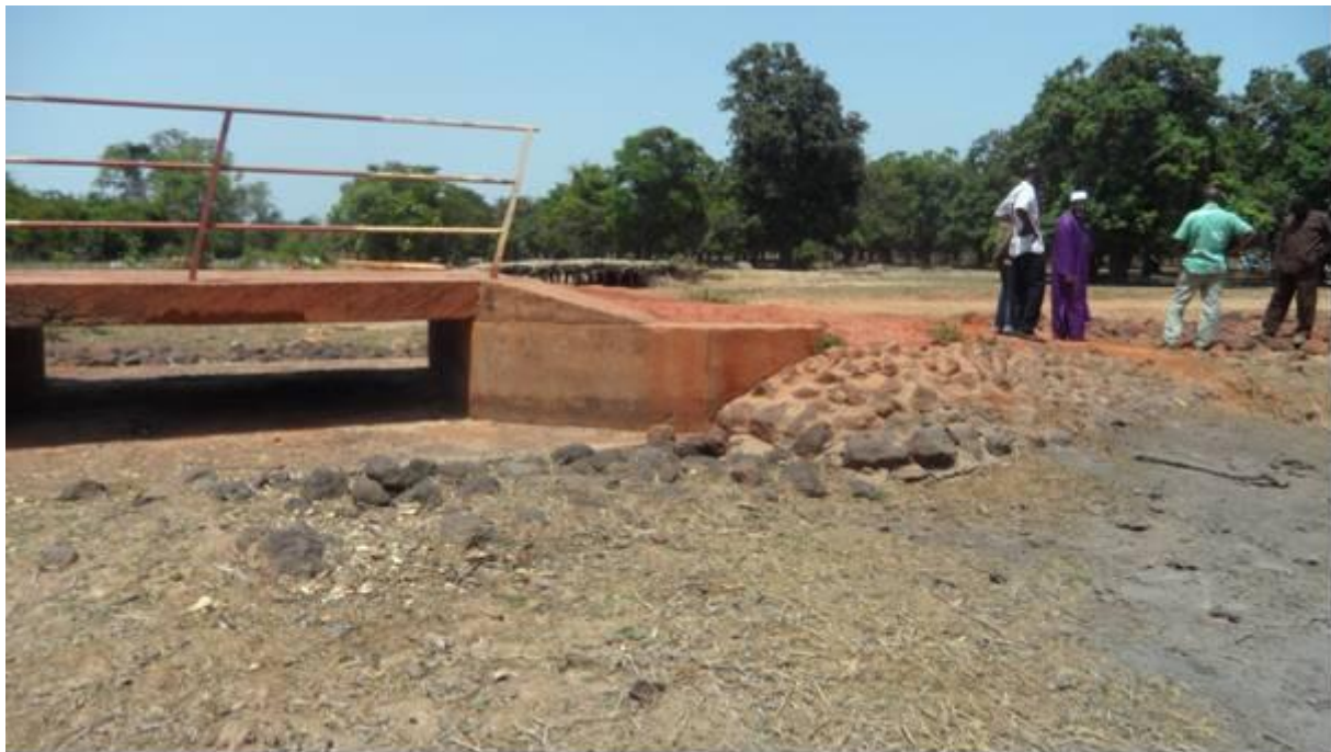
Dalot de hauteur 90cm au lieu de 1.5m
