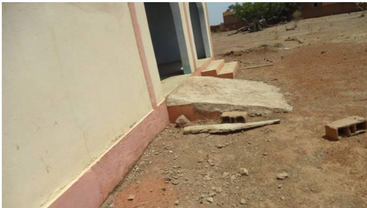
Fissure au mur
