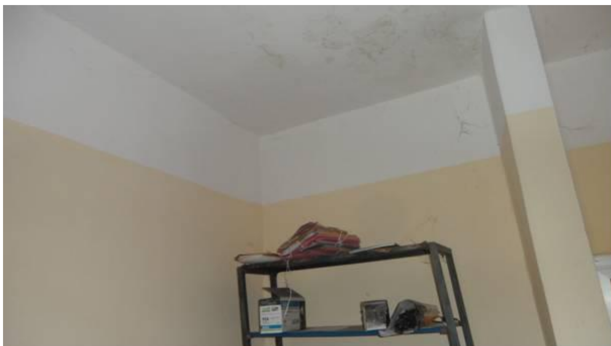
Plafond et murs mouillés à cause d'infiltration
