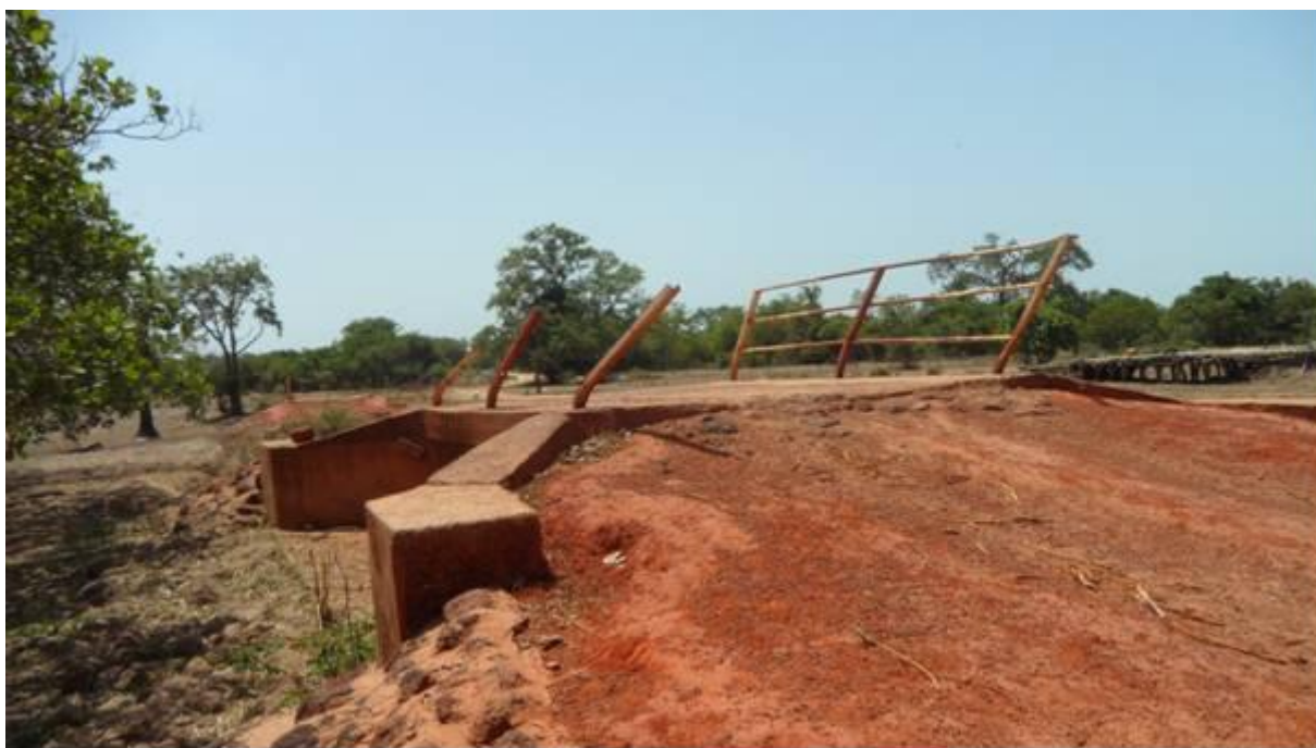
Mauvais accès aux ouvrages
