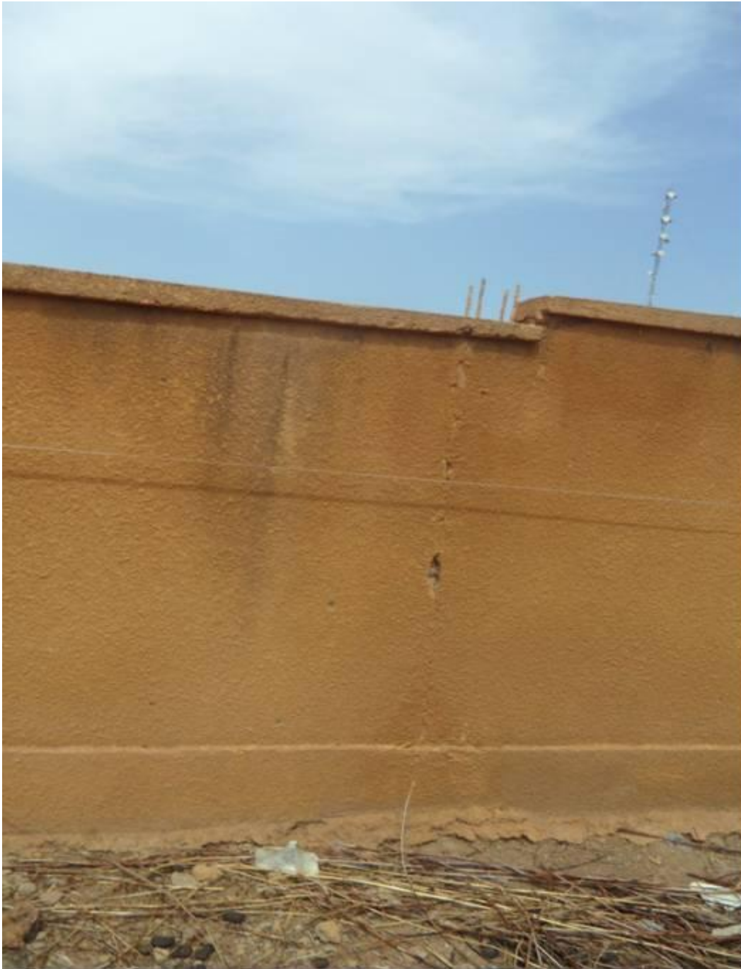
Clôture de marché de base fissurée, noter absence de poteaux raidisseurs
