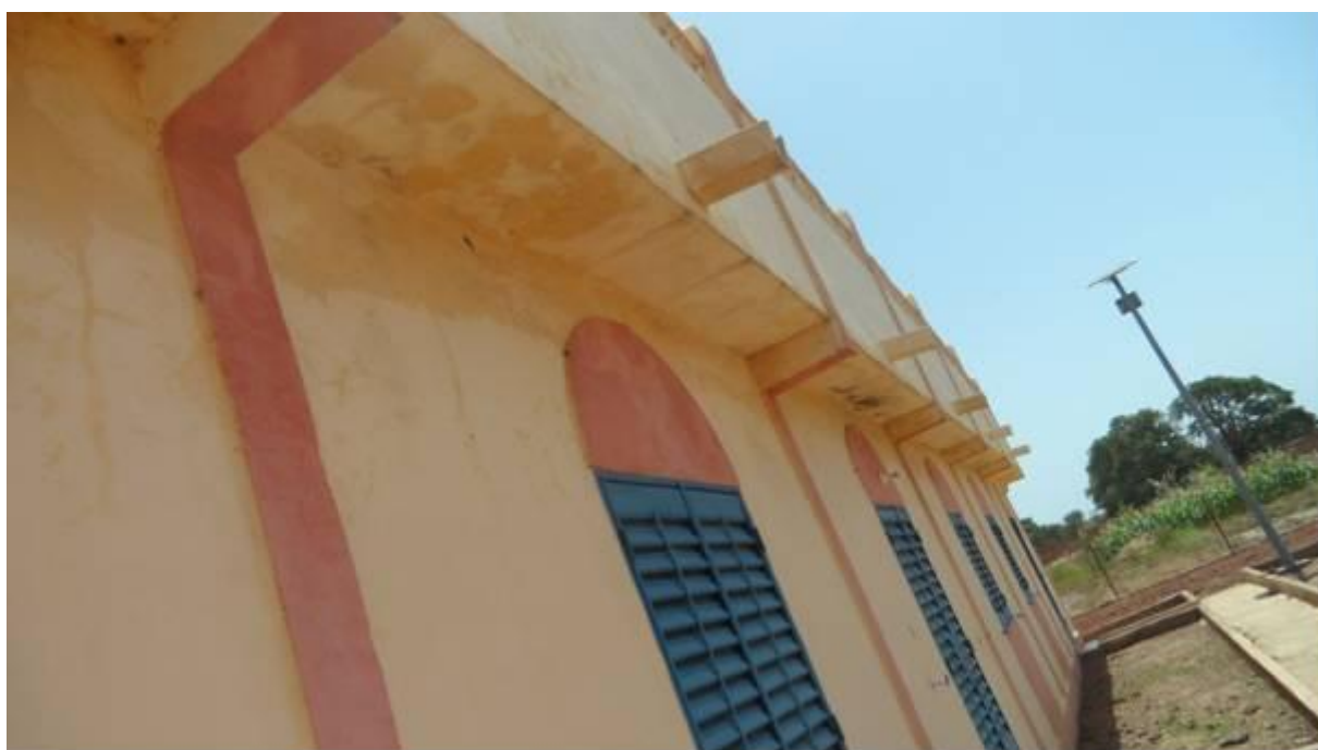
Murs et plafond mouillés pour cause d'infiltration dalle
