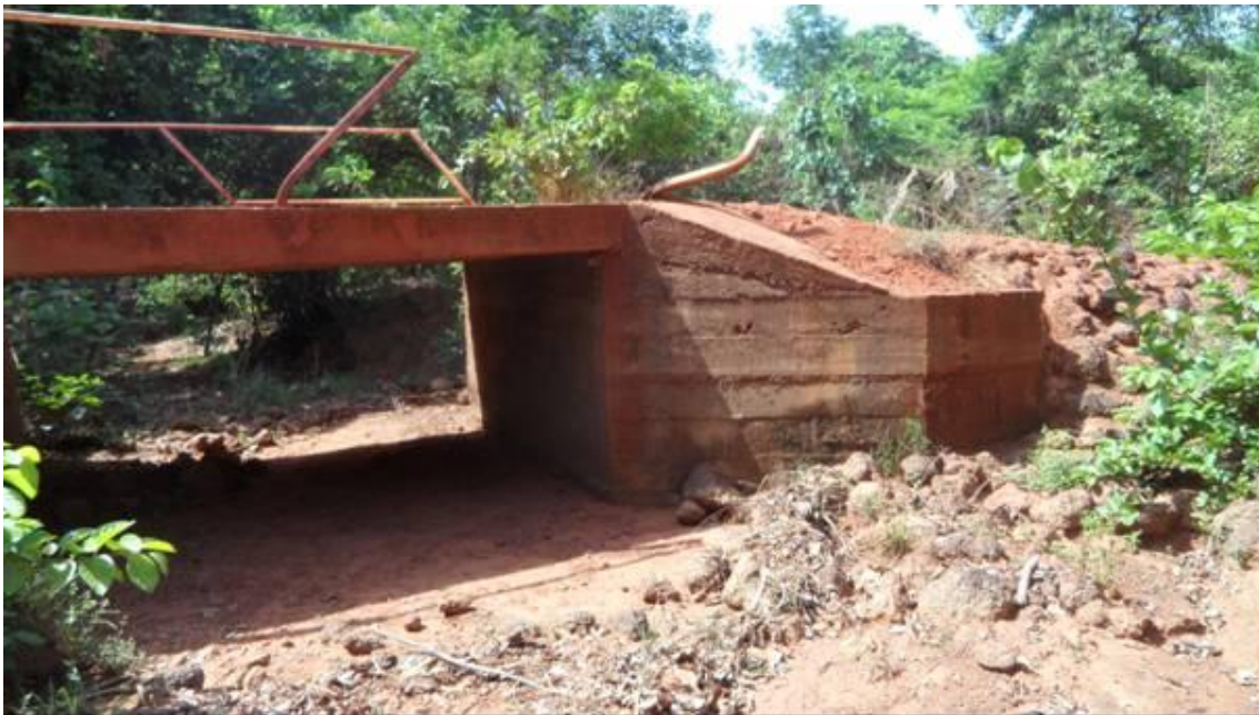
Le piédroit n'est pas enduit
