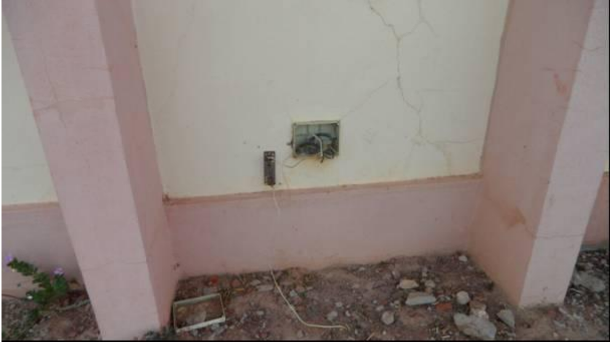
Mise à terre incorrecte du bâtiment (fil inadapté)
