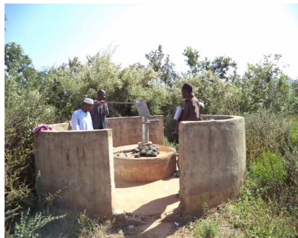
Puits à grand diamètre du poste de Mamaribougou
