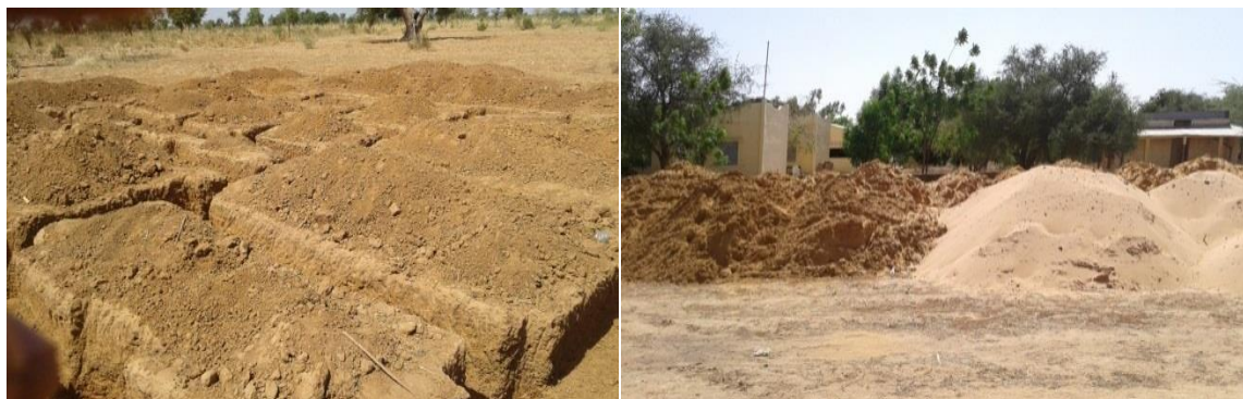
Images des travaux de creusement de la fondation du logement du Directeur.
