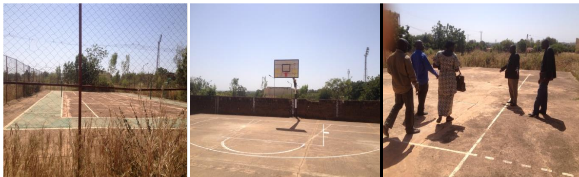
Installations des trois terrains non réceptionnés et en état de dégradation.
