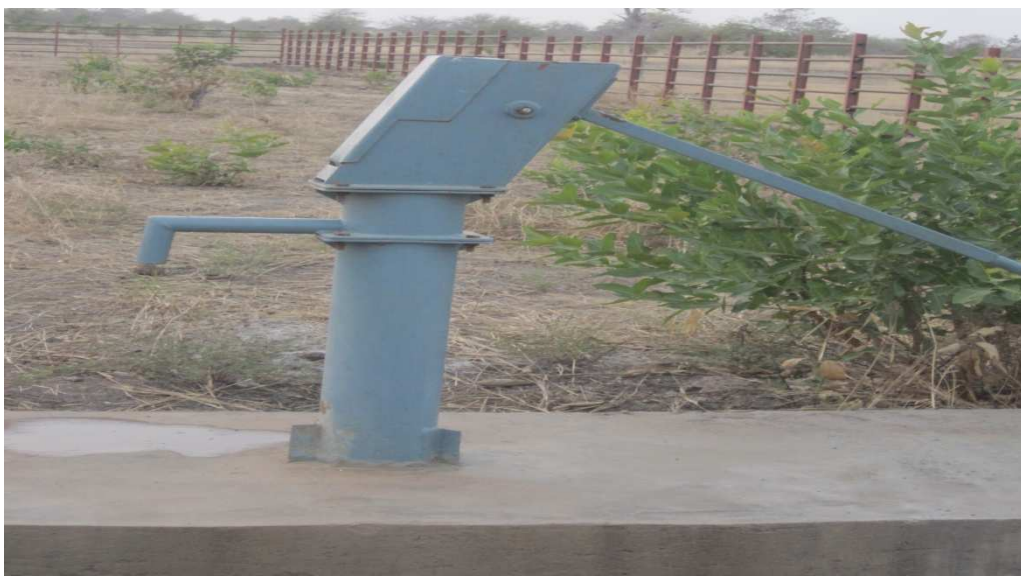
Pompe manuelle réalisée à la place d'un château d'eau prévu dans la construction du marché à bétail de Bafoulabé
