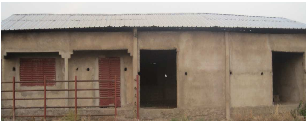
Vue du magasin et le bureau de la coopérative des éleveurs au niveau du marché à bétail, arrêté au niveau des travaux de finition en raison de l'incapacité financière, technique et matérielle de l'entreprise
