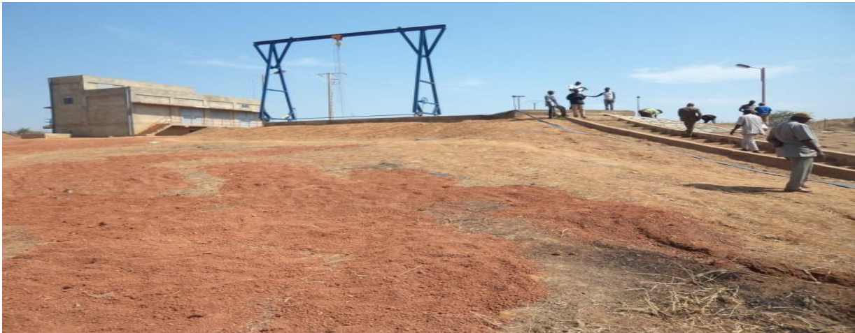
Station de pompage réalisée par le PDIAM pour l'irrigation de 685 ha à aménager par le Projet
