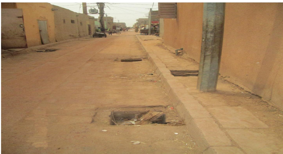
Les regards de transit dans une rue
