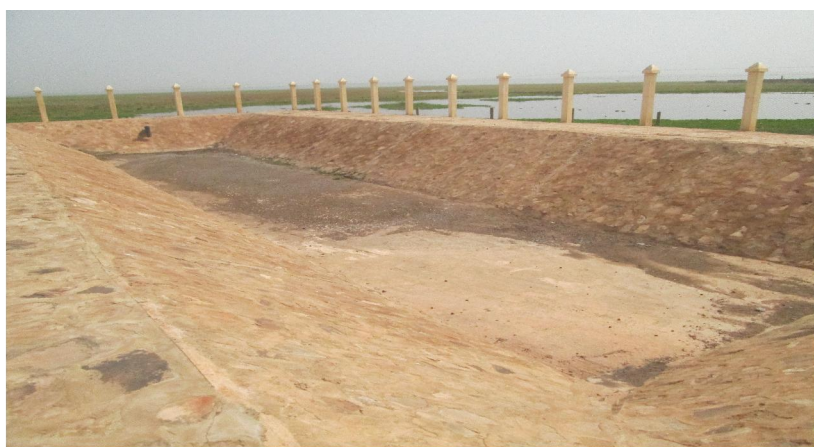
Le bassin de maturation
