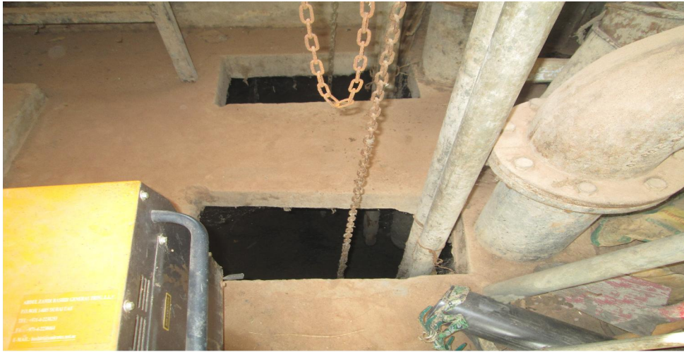
La Station de relevage de Mossinkoré
